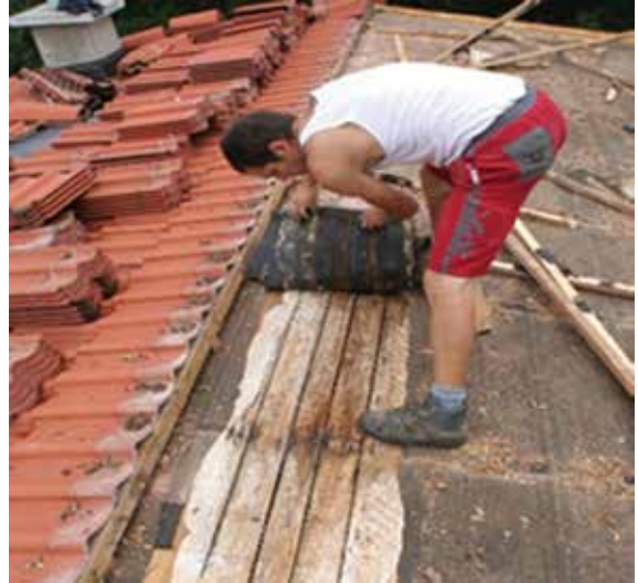
Primer problema uzrokovanih kondenzacijom: Neparopropusan materijal je sprečio otparivanje vlage iz unutrašnjeg prostora i oštetio konstrukciju.
